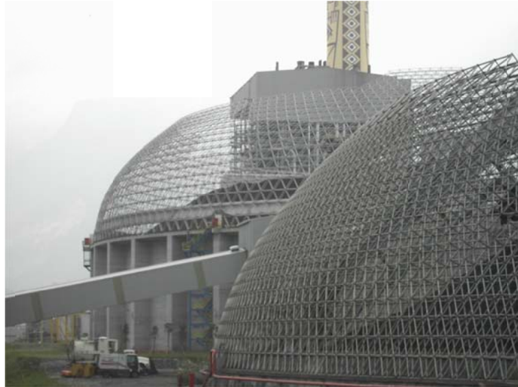
圖 6 和平電廠煤倉受海棠颱風破壞後之側面圖
