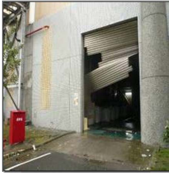
圖 9 廠房機具出入口不鏽鋼捲門變形破壞
