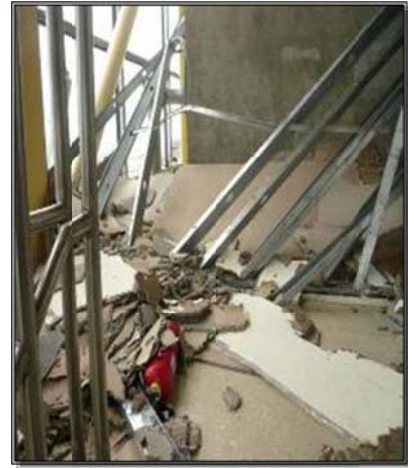
圖 8 廠內混凝土牆隔板損毀情形
