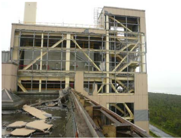
圖 7 廠房外牆水泥板毀損
